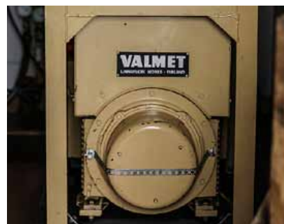
Ce générateur a 30 années derrière lui.
