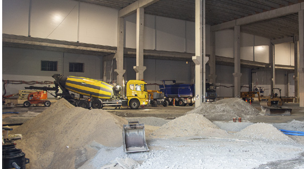
Une vingtaine de personnes en moyenne ont travaillé sur le chantier de l'usine de transmissions, mais leur nombre a beaucoup varié en fonction de l'avancement des travaux.
